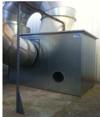
Cabine sur Ventilateur
