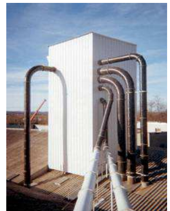
Traitement sur cyclone par Encoffrement complet
